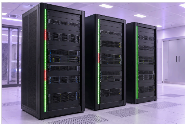
Ejemplo de estado del rack: fallos seleccionados en rojo; estado normal en verde.
